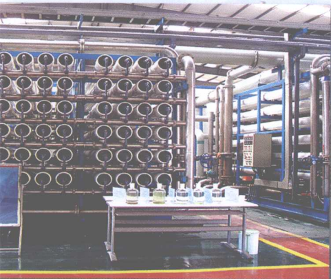
全国最大的工业污水膜法处理工程
