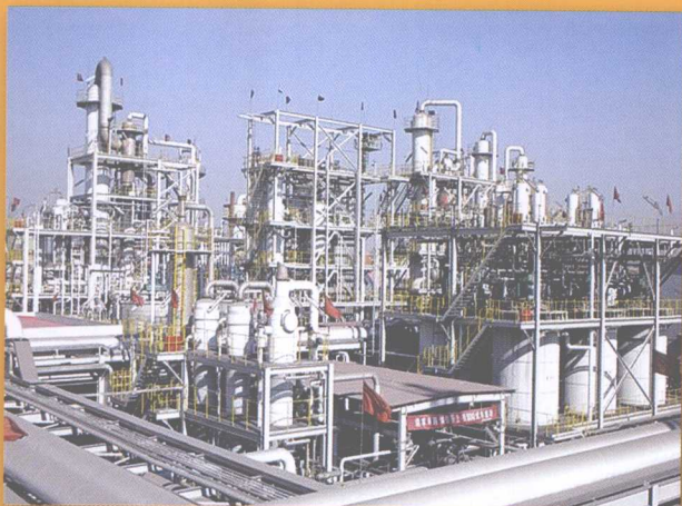
阳煤集团三维股份公司年产8万吨1.4—丁二醇生产线
