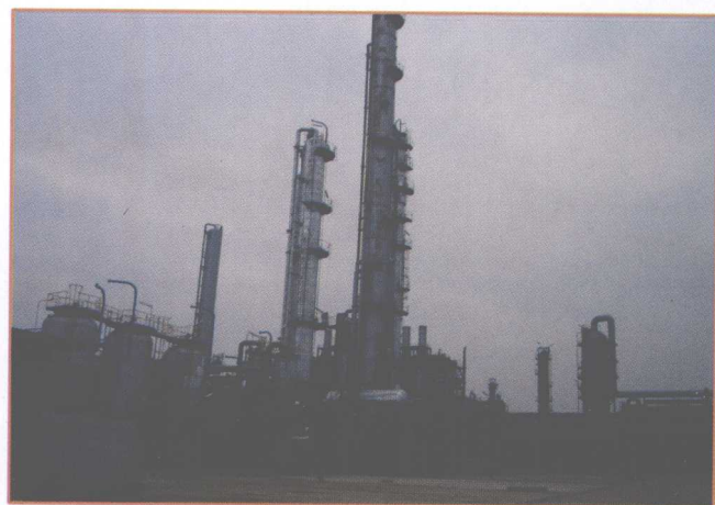
扬子液态乙烯工程，-110℃
