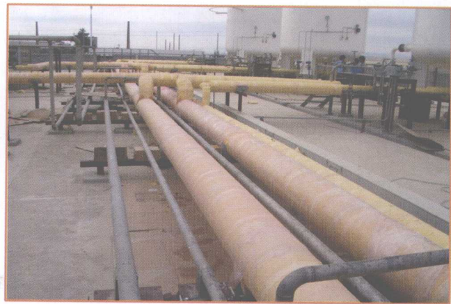
液化天然气(LNG)接收站，-163℃
