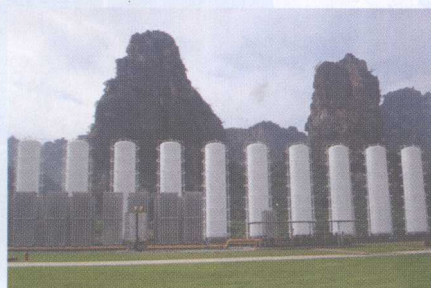
10×100m 3 /d LNG汽化站
