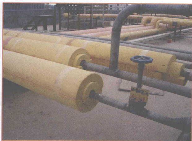
厦门柯达工程冷冻水工程，-10℃
