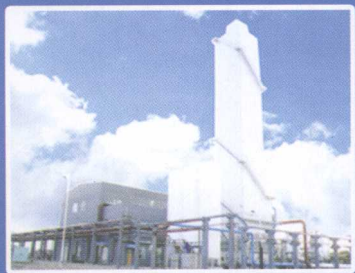
◆ 安装在内蒙通辽的 10000m 3 /h 空分设备
