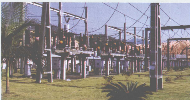
建于 1994 年的 11 万伏变电站
