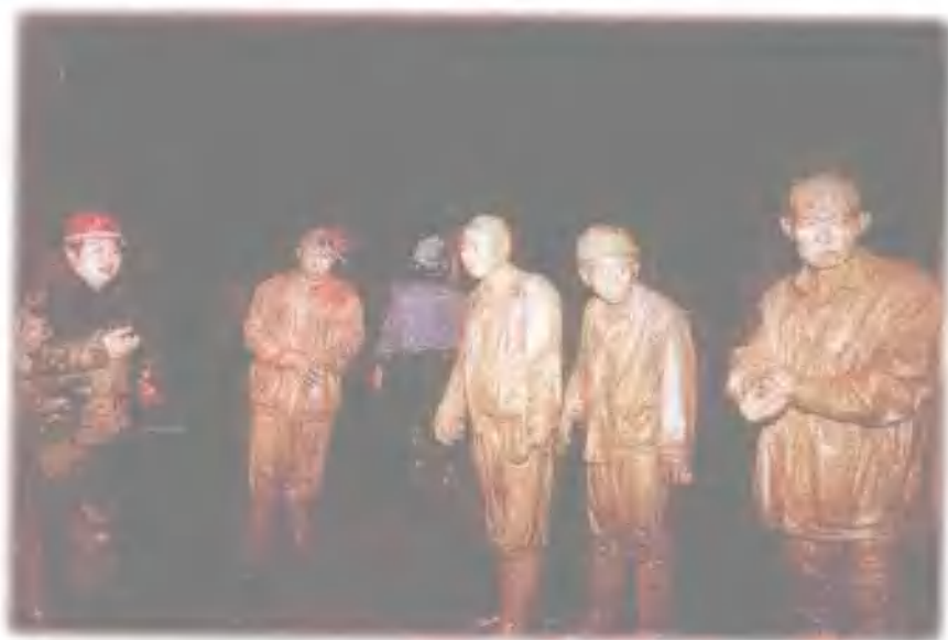
中铁十八局集团在彭水 隧道进口施工中遇到突 泥的情景
