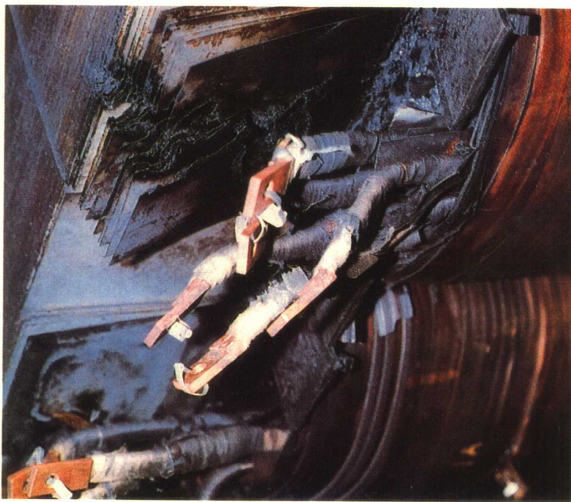
图10.4 如何实施维护程序，通过油中可燃气体分析进行的早期检测可防止这种电弧炉变压器退出运行。由于必须停止全部生产，所以这种工业设备不能关闭。已出现这样的情况，即用户已检测气体体积，而且在不可避免的故障之前，已幸运地有一台新变压器运抵现场。根据随后的目测可以发现，该变压器已发生一次绕组对地闪络；进一步观察发现，一次绕组上的绝缘隔板已完全烧坏。
