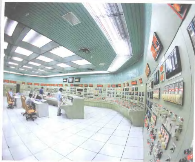
秦山核电站主控室
