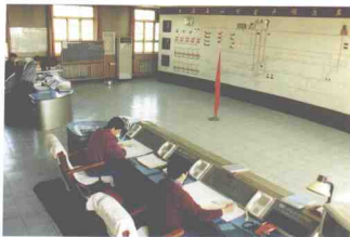
生产调度室调度
