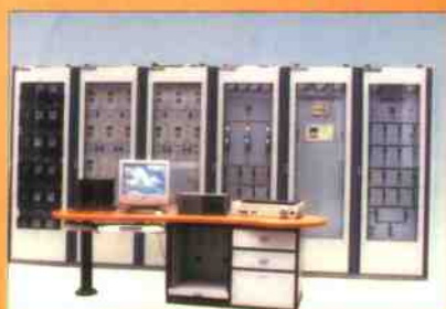
PSU 变电站综合自动化系统
