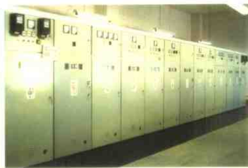
10kV 高压开关柜
