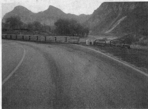
图 1-4 配筋很低的桥梁栏杆
