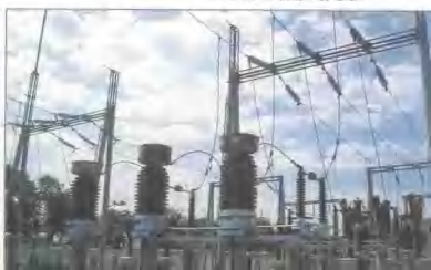
金山县11万伏高压变电站。
