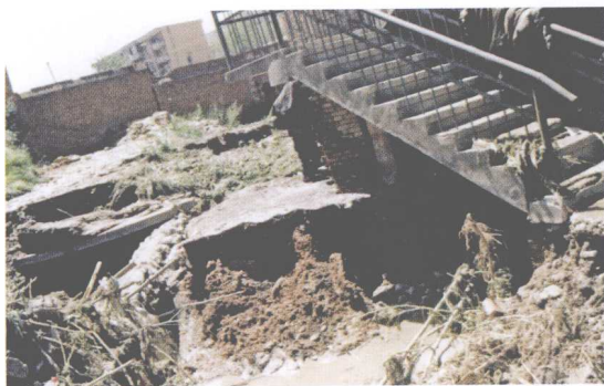
被洪水冲毁的桥洞
