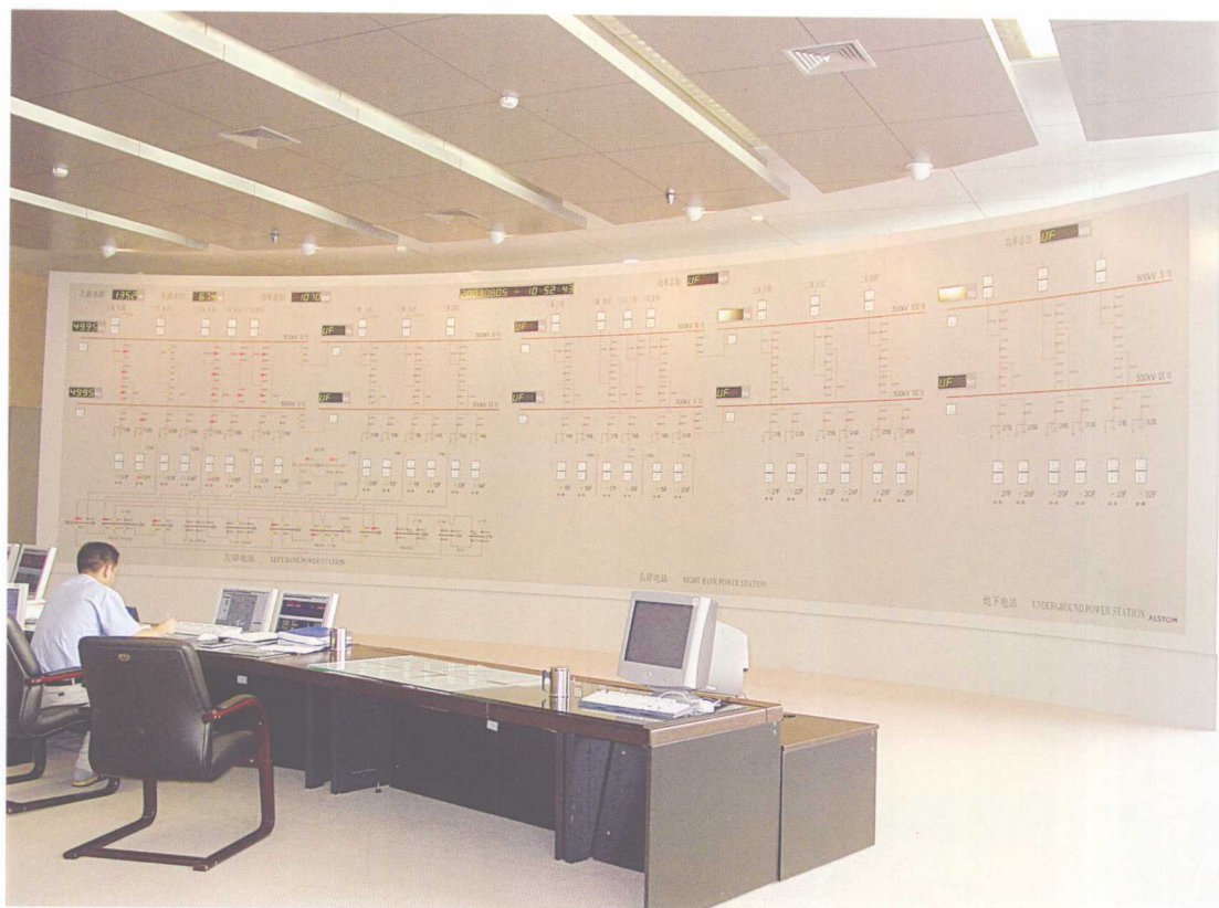
左岸电厂中央控制室
