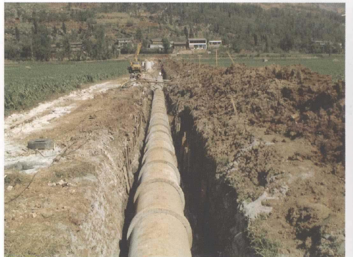
◆ 皮家寨岩溶大泉束流调压壅水工程倒虹吸引水管
