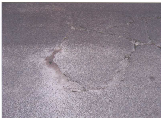
(十四) 半刚性基层公路病害照片
