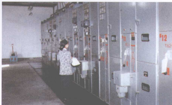
新登煤矿35KV变电站
