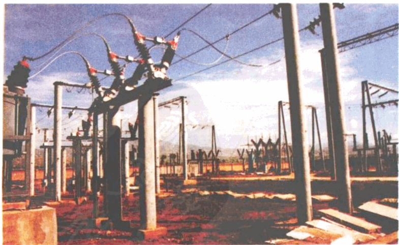
5、凉城 11 万伏变电站一角
