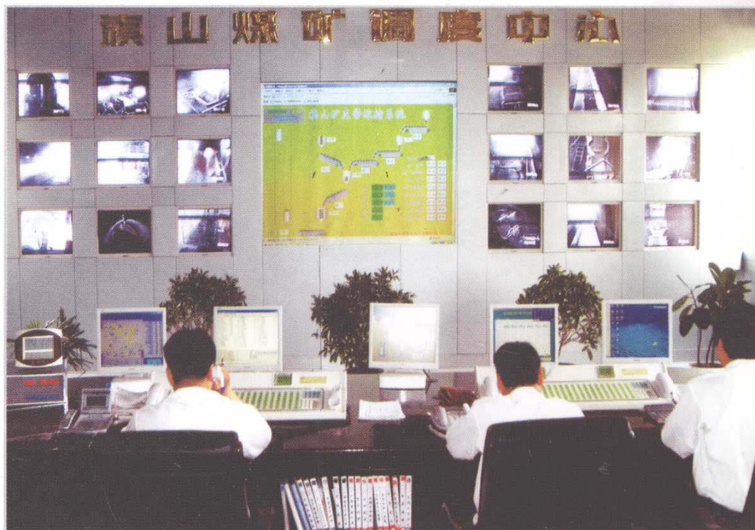
徐州矿务集团旗山煤矿现代化调度中心(集井下数字化控制、瓦斯监测、监控、井下关键点及运输系统可视化监控于一体)
