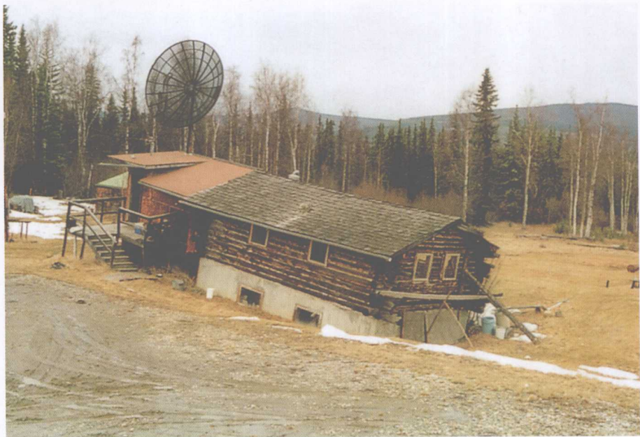
永冻土融化对费尔班克斯附近一幢房屋造成损坏。这幢房子在四十年前造好时,地面是平的!
