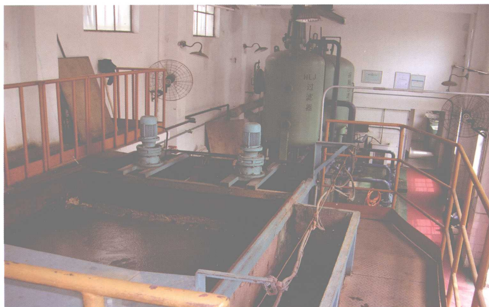
某厂含油废水工程破乳气浮池
