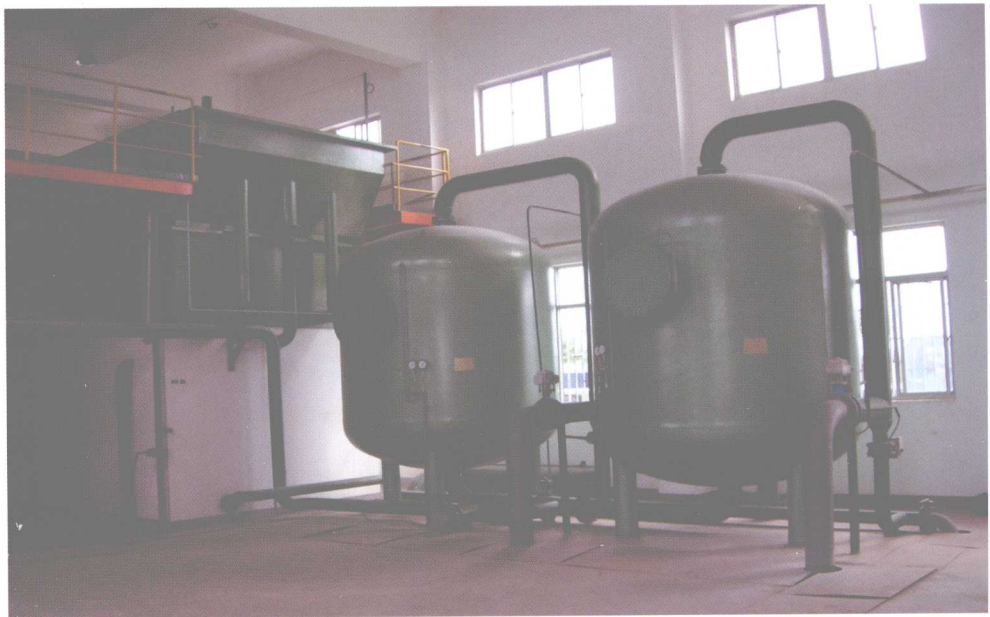
某厂电泳涂装废水中水过滤器
