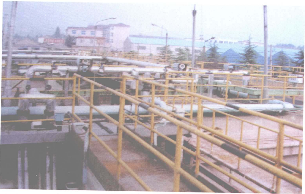
某厂磷化电泳废水调节系统
