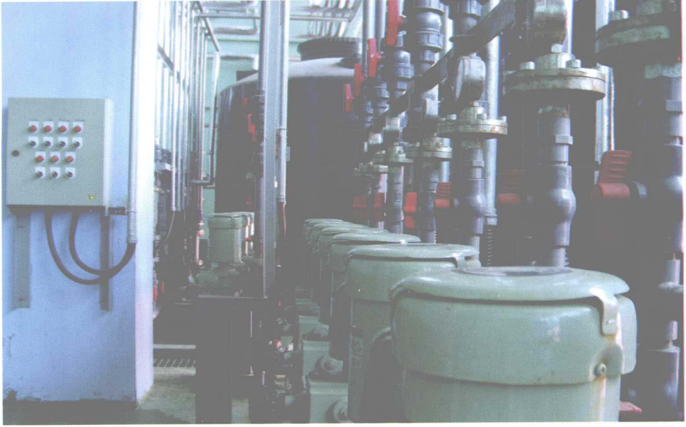
某电镀废水投药系统
