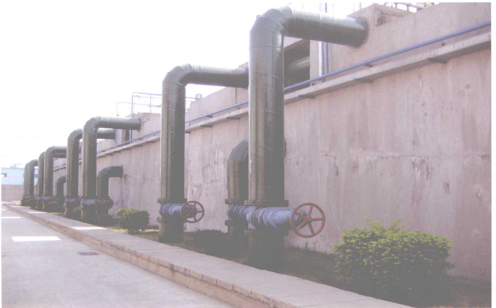
某钢铁工业废水工程虹吸滤池
