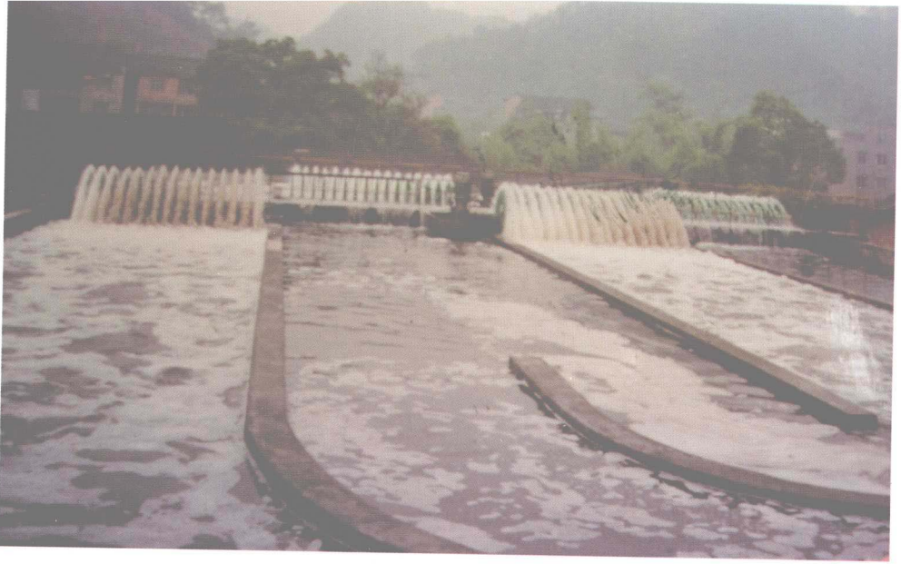
某厂废水处理氧化沟系统
