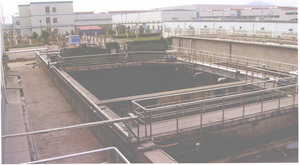
某厂电泳涂装废水工程调节池
