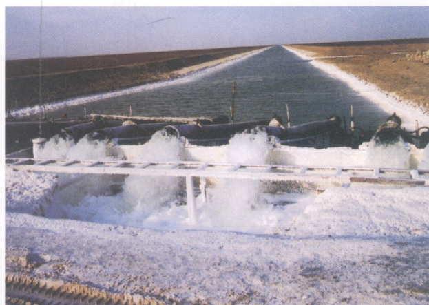
照片3 罗布泊钾盐公司罗北凹地输卤渠
