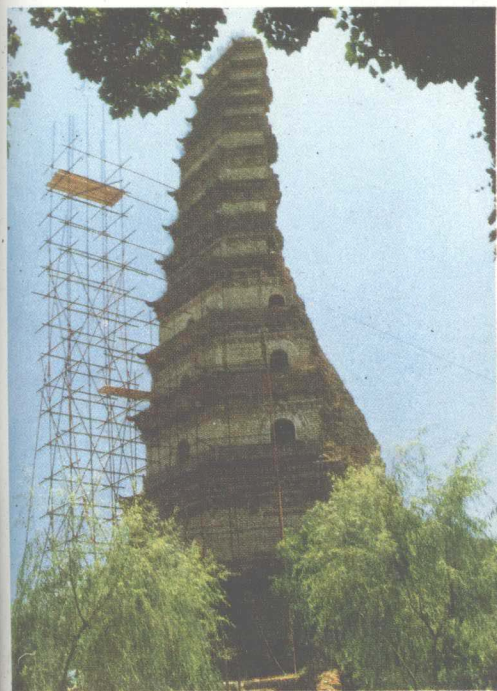
倒塌后的法门寺明代砖塔
