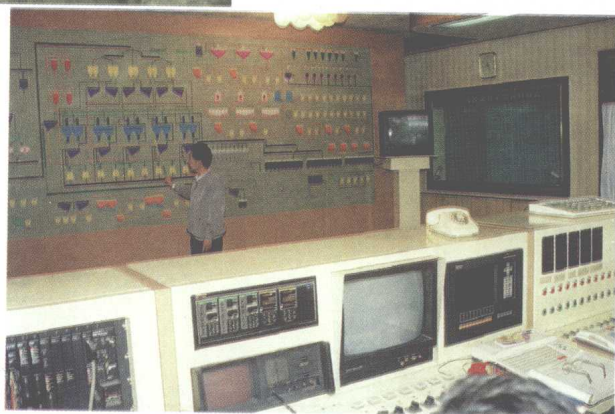
株洲洗煤厂洗煤车间 的集中控制室
