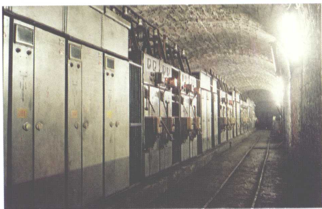
地处湘中大水矿区的 恩口煤矿井下中央变电所
