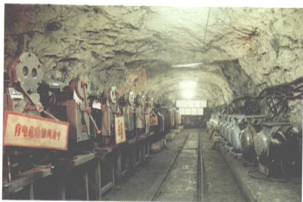
煤炭坝煤矿的采区变电所
