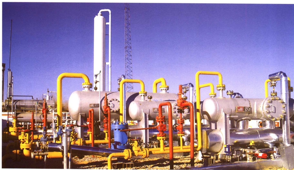
2006 年，中国石油天然气集团公司全年完成天然气销售量 372 亿立方米，同比增长 28.3%。图为长庆苏里格气田集气站
