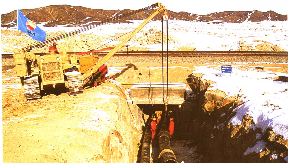
2006 年 10 月 21 日，从乌鲁木齐到兰州，全长 1800 多千米的西部成品油管道投产，为新疆油品外输打开了一条高效便捷的通道。图为西部管道穿越铁路
