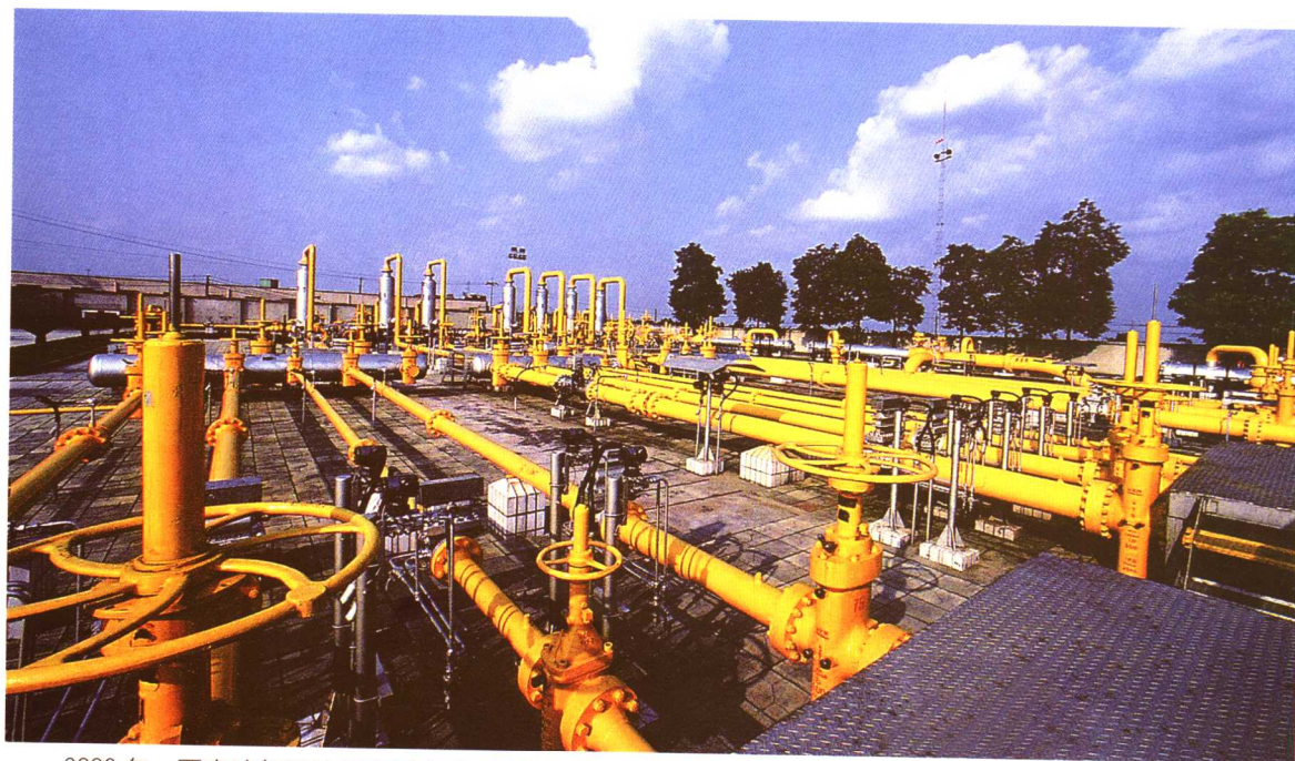
2006年，西南油气田油气当量突破1000万吨，成为我国又一个千万吨级油气田。图为西南油气田配气站
