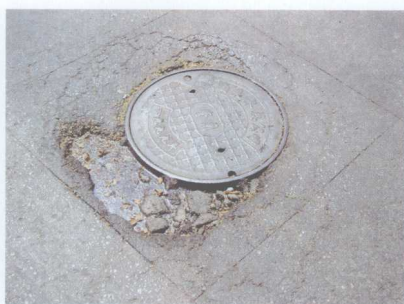
图 1.1-14 井周碎裂、下陷
