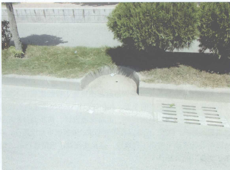
图 1.1-20 井盖隔断路缘石
