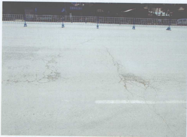
图 1.1-1 交通流量和荷载增加造成路面损坏
