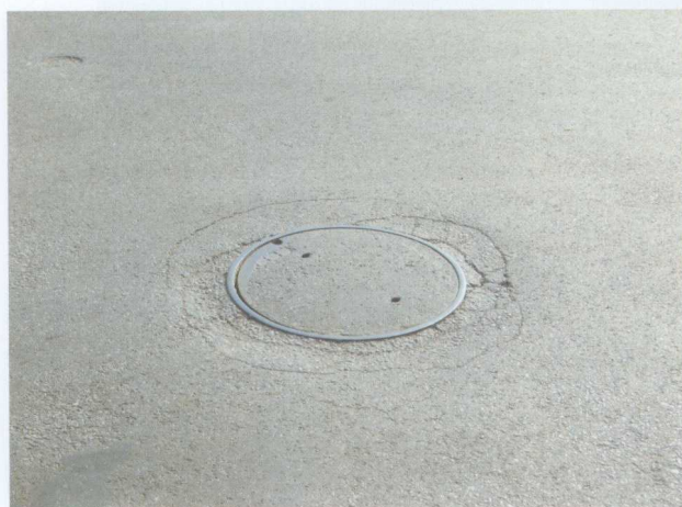
图 1.1-11 井周碎裂、下陷
