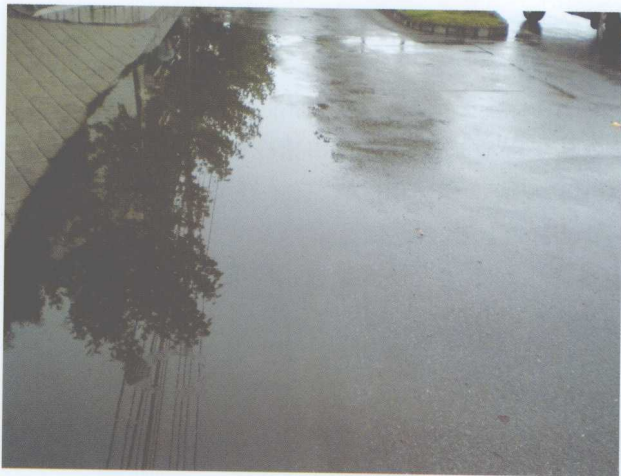
图 1.1-3 路口无排水设施
