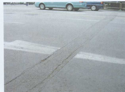
图 1.1-10 二次开挖道路造成的路面沉降
