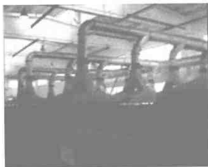
图1—7 焊接现场机械通风系统
