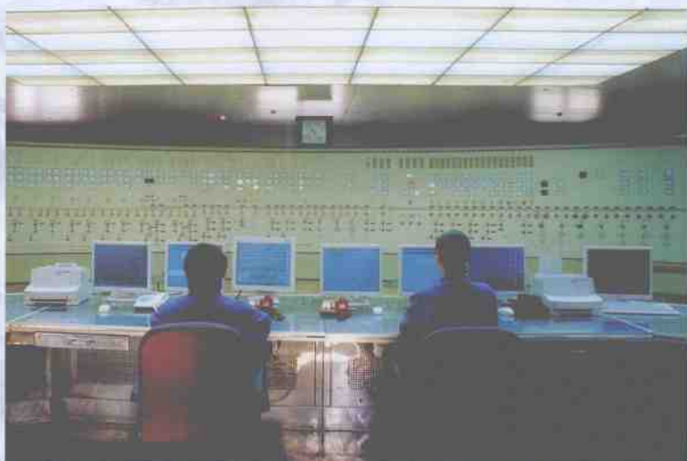
● 二、三期网控室
