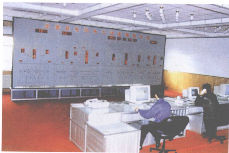
望奎县农电局调度室
