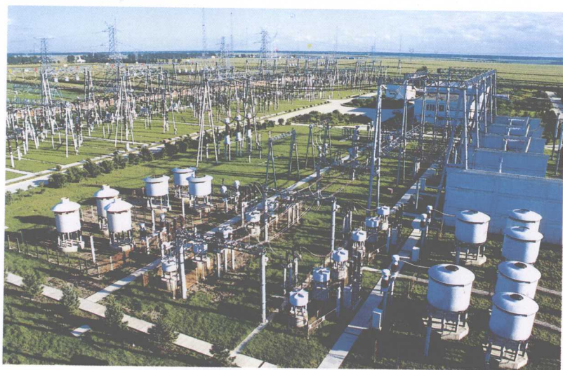
黑龙江省第一座500千伏变电所——哈尔滨电业局哈南变电所
