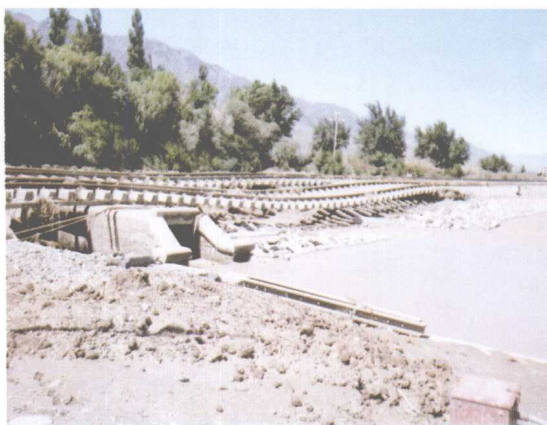
兰新铁路达坂城段被冲毁。
