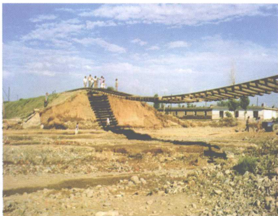
北疆铁路部分路段被冲毁,铁轨悬空。
