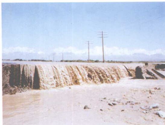
白杨河公路大桥被冲毁之二。
