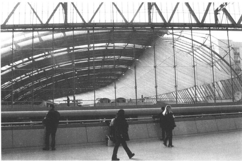
天窗下面挂了幕布以免行人被坠落的玻璃砸到。这种玻璃失效是由硫化镍石造成的。 伦敦滑铁卢车站国际站区
