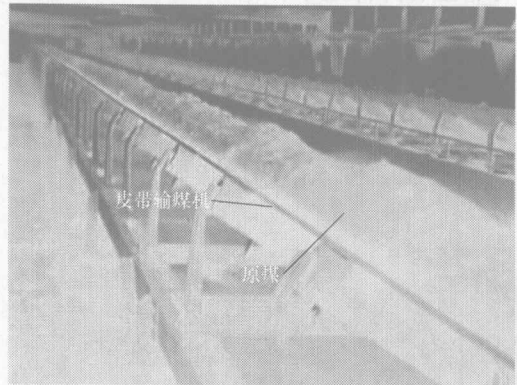
图 1-9 皮带输送原煤的过程
