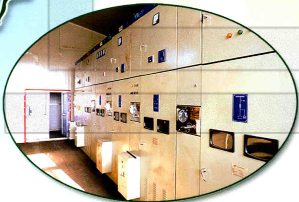
井上 10KV 配电柜
