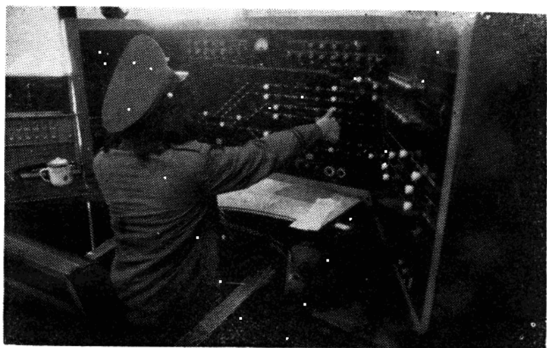
西昌南电气集中控制台
