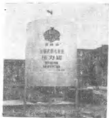
新建的无塔式自来 水系统（压力罐）
