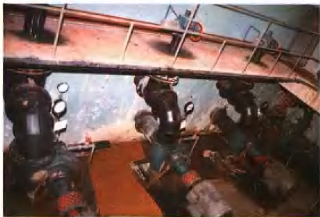
江边水厂一级泵站
