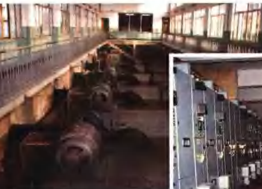
金山水厂二级泵站
