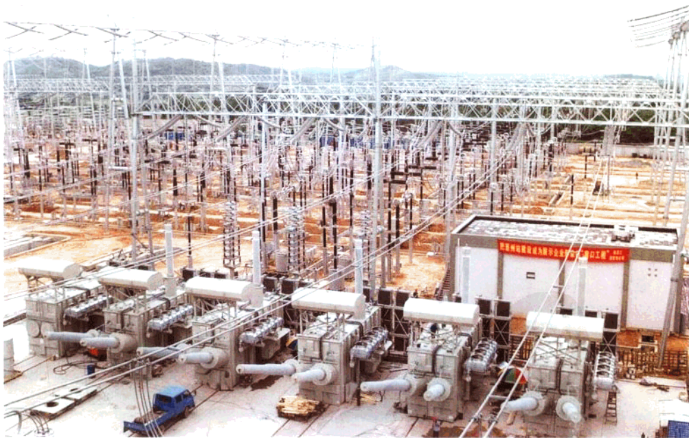
500kV 三峡送出工程广东惠州换流站(2002)
