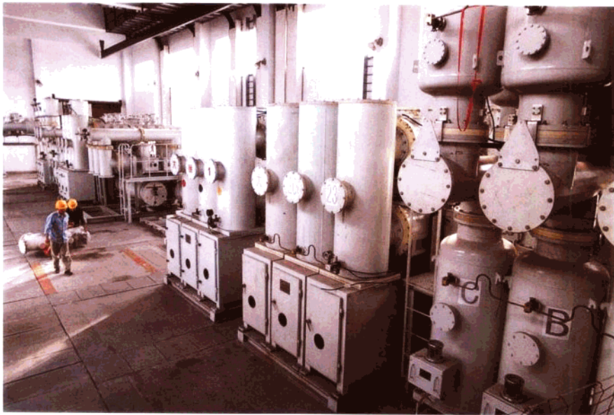
220kV 郑州人民变电站(全室内),GIS组合电气设备(2001)
