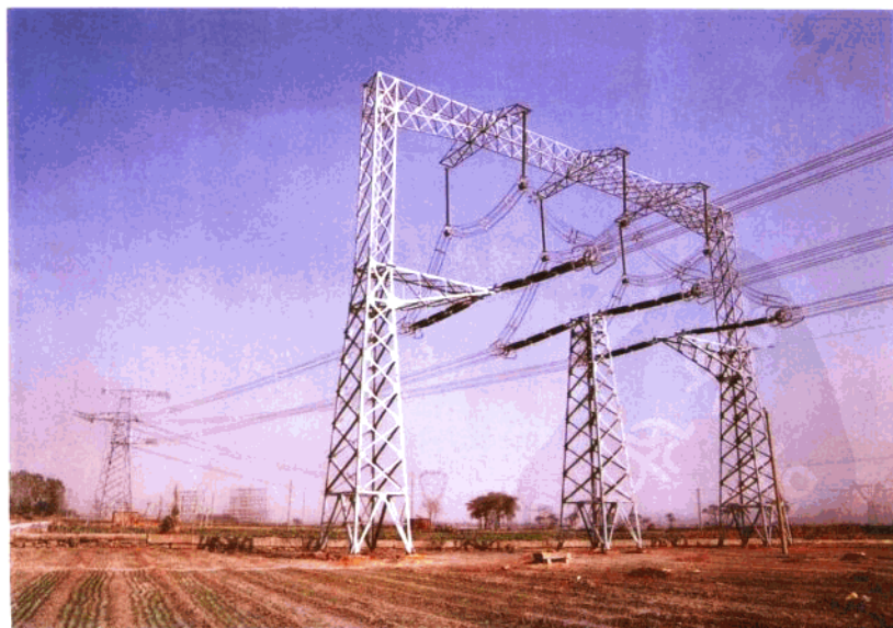
中国第一条500kV 六分裂紧凑型新(乡)— 安(阳)—邯(郸)输电线 路工程(2002)
