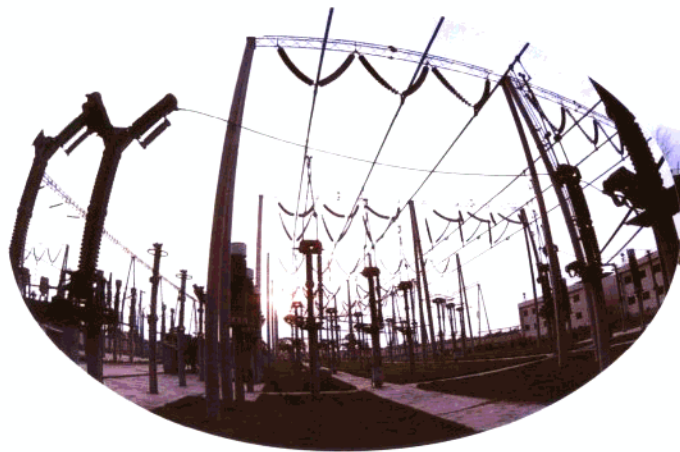
承建220kV安阳杜家庵变电站(1991,部优)
