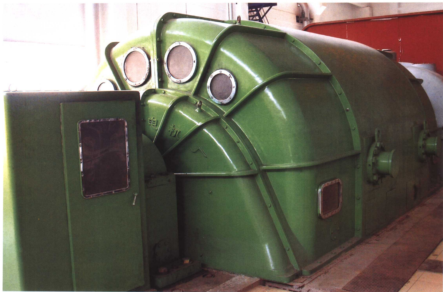
▲ 扬子石化热电厂增建60MW备用发电机组
