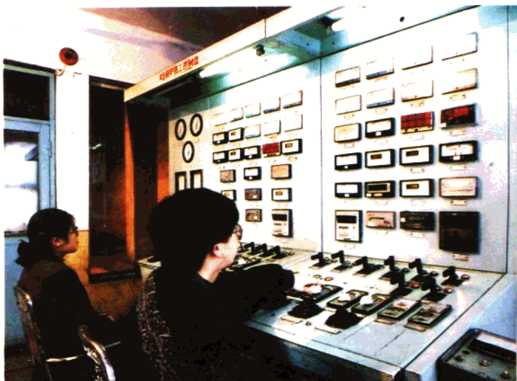
► 发电厂热控室
