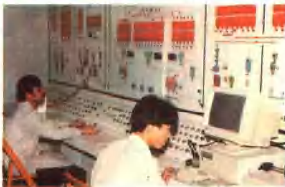
江西永惠饲料公 司生产车间微机控制 室
