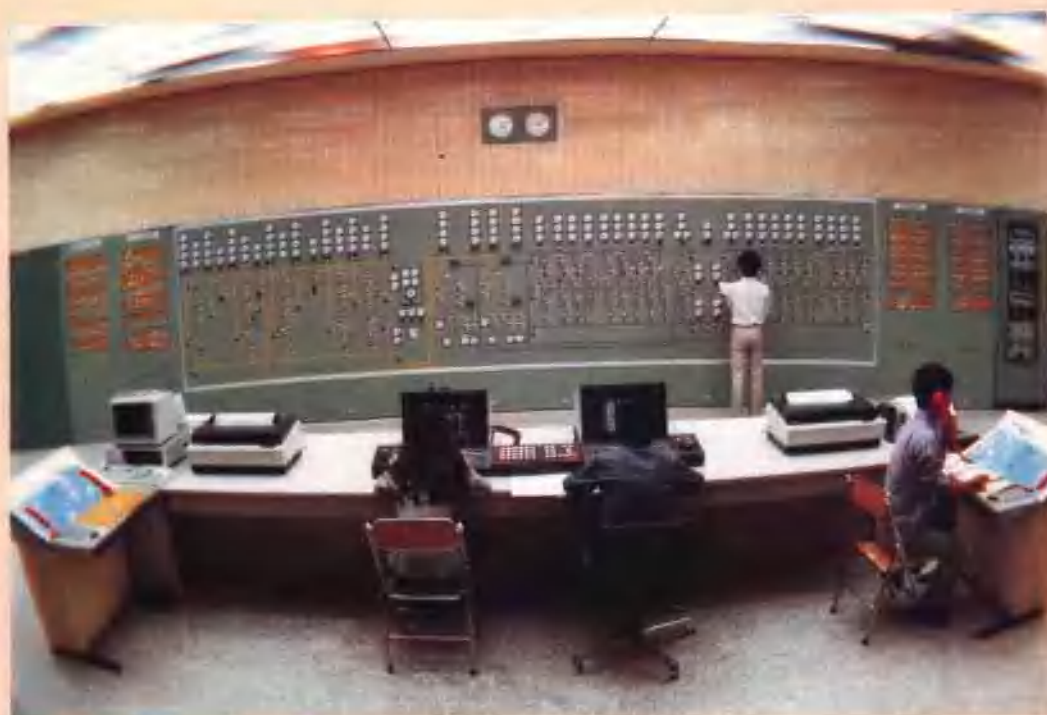
500 千伏郑州（小刘庄）变电站总控制室
