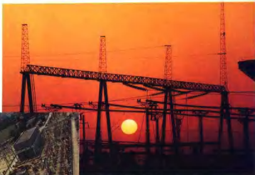
运行中的220千伏常庄变电站
