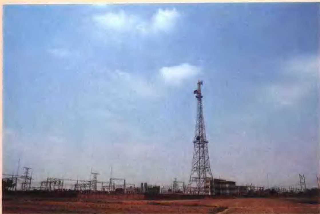
新扩建220千伏峡窝变电站
