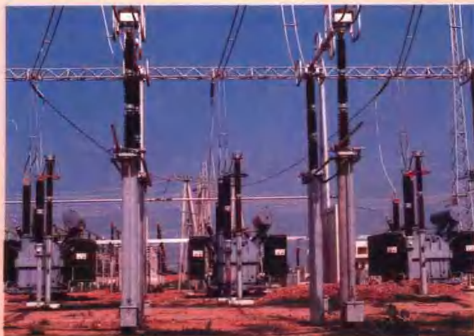
500 千伏郑州（小刘庄）变电站主变压器
