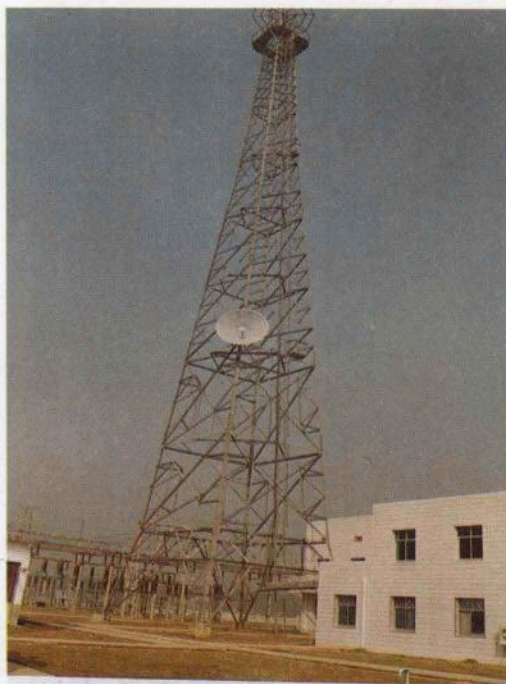
220 千伏变电站微波通讯塔
