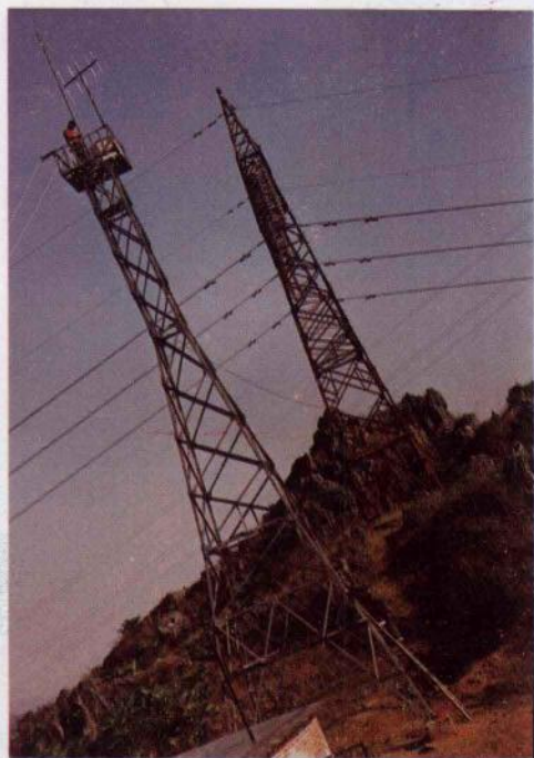
220 千伏线路熔冰监视塔
