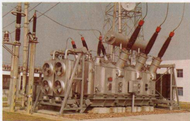
湘潭荷塘 220 千伏变电站变压器
