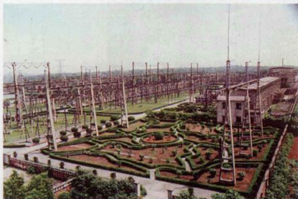
湘乡泉塘 220 千伏变电站
