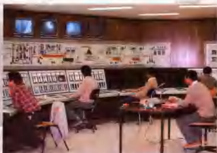
我院工程技术人员在卡尔巴拉水泥厂中控室对全厂各工段进行生产操作控制。（照片提供 汪宜光）
