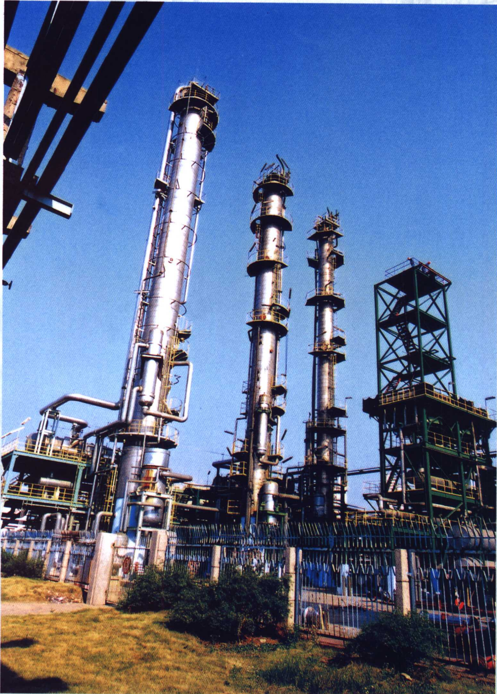
环氧乙烷装置
