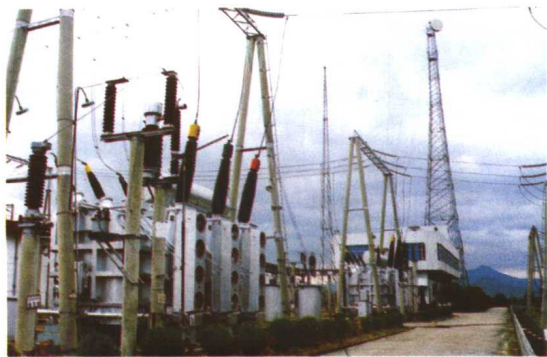
34 220 千伏惠安变电站 (容量 24 万千伏安)
