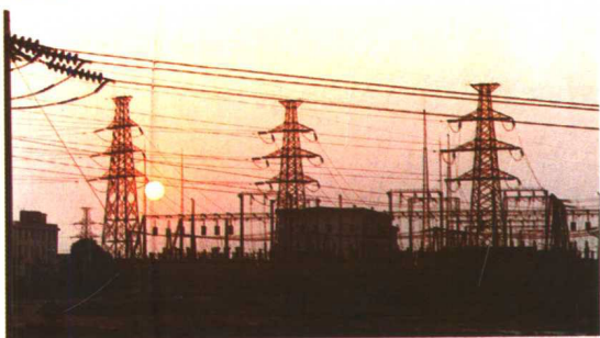
32 220 千伏井山变电站 (容量 24 万千伏安)
