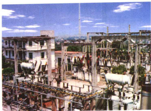
31 110 千伏后茂变电站 (容量 6.3 万千伏安)
