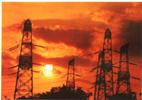
29 220 千伏井山至笏石 I、II回输电线路
