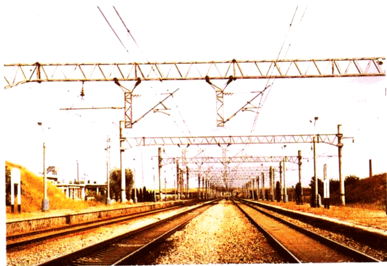
京秦线的硬横跨 接触网
