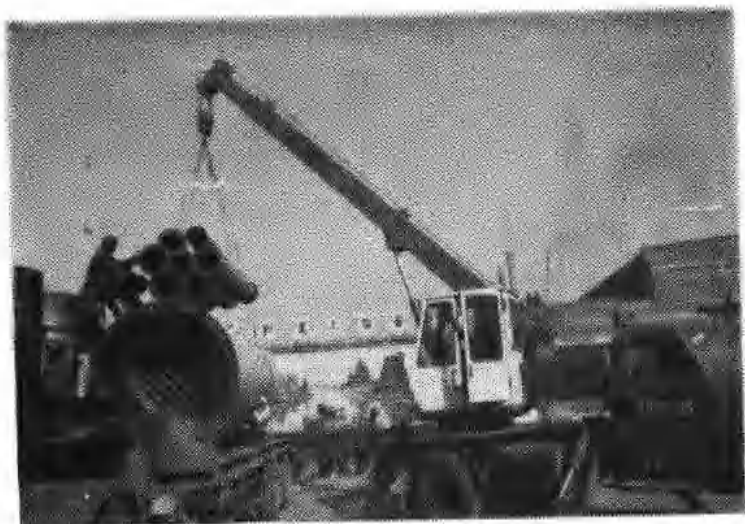
环保设备厂，正在为用户装运锅炉
