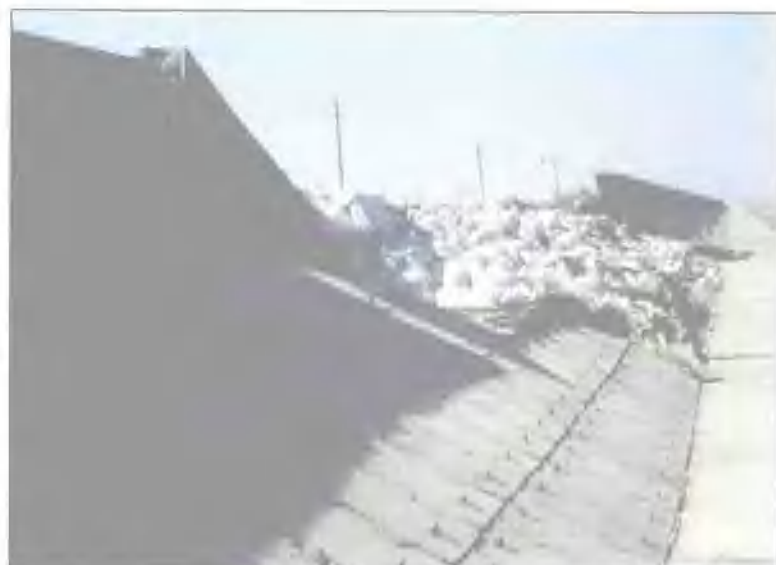
图 10 10 月 12 日黄河海港附近海堤遭受巨浪袭击严重损坏
