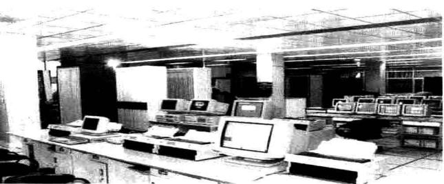
县电信局机房一角
