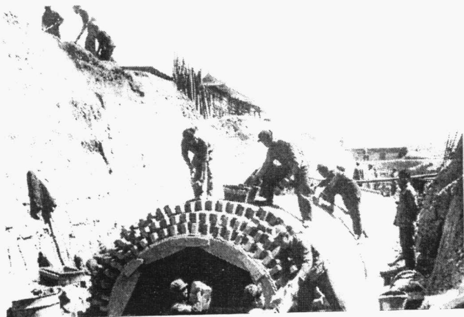
图4 德胜门地区下水道
