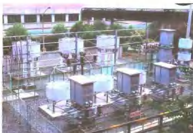
图为改造中从瑞典引进的SVC无功补偿装置。
