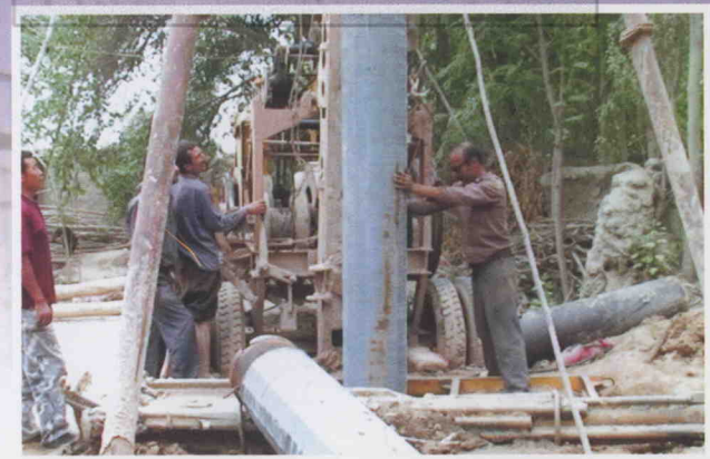
防病改水工程
